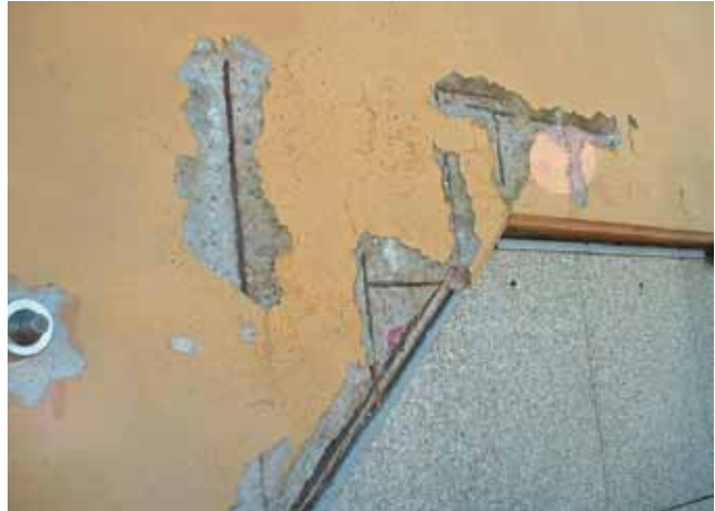
Barsten in een gevel vanwege een te geringe betonbedekking.
