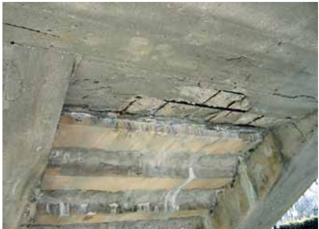
Corrosieschade aan de onderzijde van een trap door een missende afdichting en door een te geringe betonbedekking.
